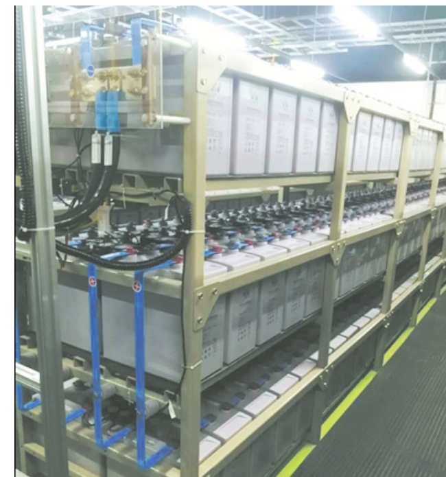
天目湖大数据中心
